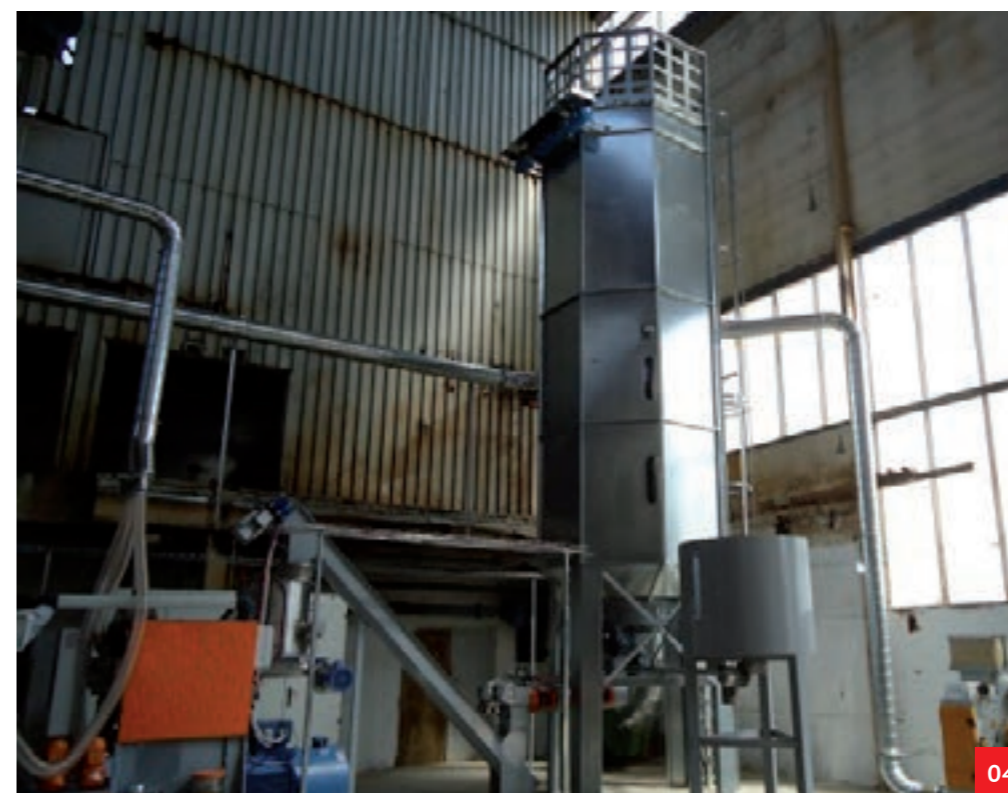
04. Prodotto raffinato convogliato al silo e poi scaricato tramite coclea su pellettatrice Refined wood chips conveyed to the silo and then discharged by a screw conveyor into the pellet machine Рафинированная продукция, направляемая в силосную башню, а затем выгружаемая
