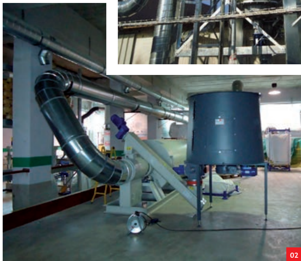
02. Dosatore che scarica su coclea per invio all'essiccatore Dosing unit discharging on a screw conveyor to feed the dryer Дозатор, выгружающий материал на шнек для отправка на сушильную установку
