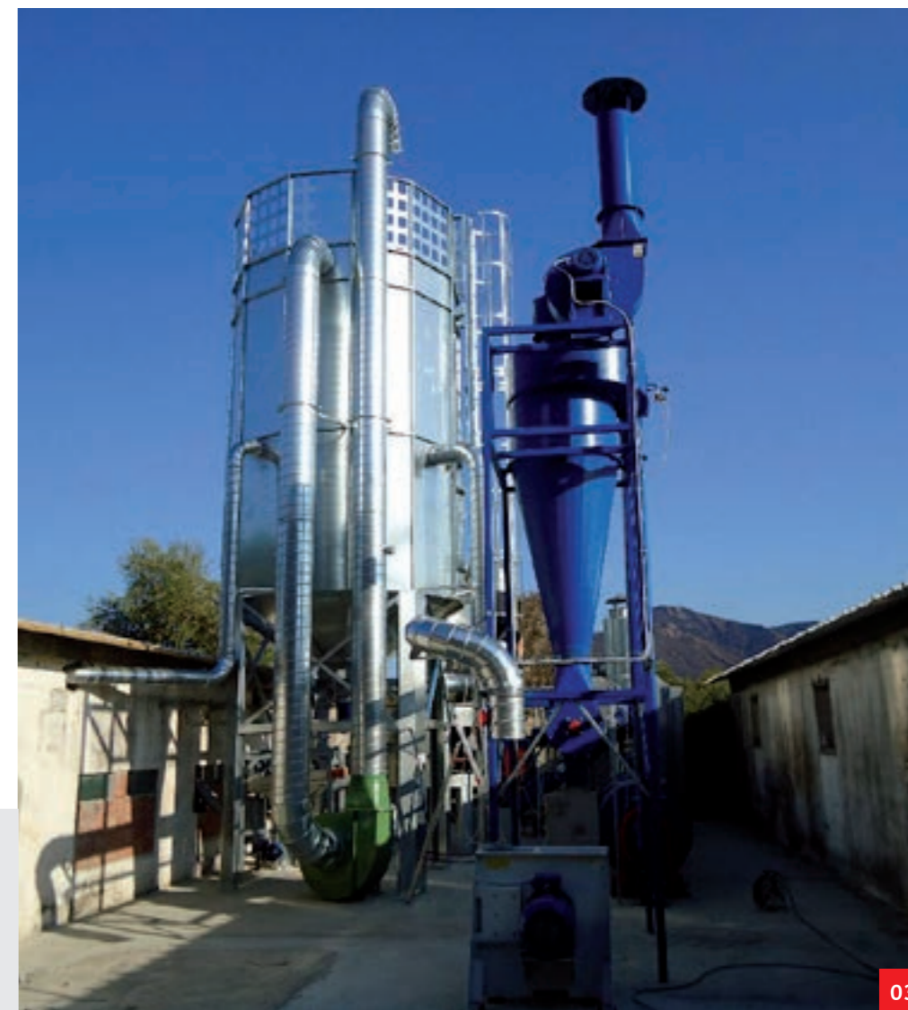
03. Silo di stoccaggio del prodotto raffinato Silo for refined product storage Силосная башня для хранения рафинированной продукции
